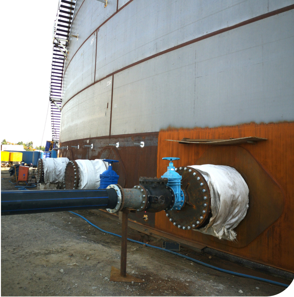
Tanklager für Rohöl an der Ostseeküste
