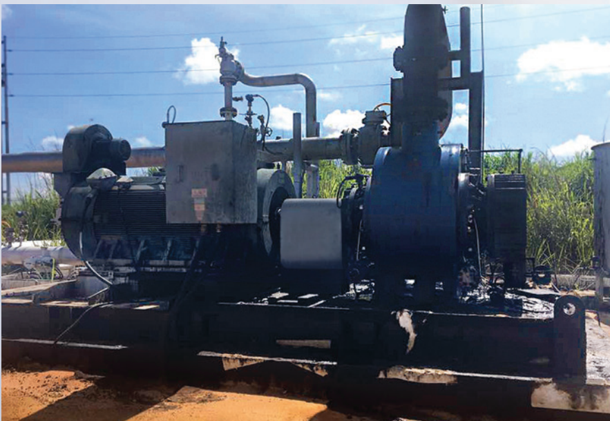
Für die Förderung des extra-schweren Rohöls sind Multiphasenpumpen im Einsatz.
