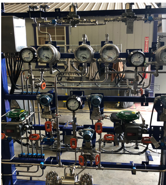
Frontansicht des Gasversorgungssystems
